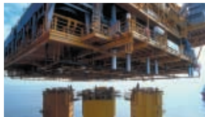
浮体部分とデッキ部分の組立工事の様子 (Marco Polo TLP)
